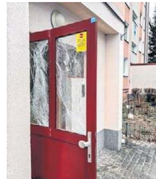
Pęknięte szybyw drzwiach wejściowych
