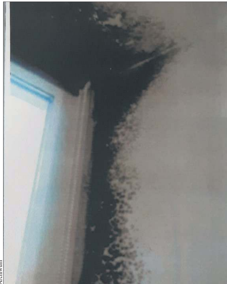
Grzyb na ścianach budynku przy ul. Kolegialnej
