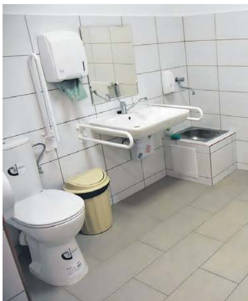
W części parterowej urzędu przygotowano w ostatnim czasie łazienkę dostosowaną do potrzeb starszych i niepełnosprawnych.
