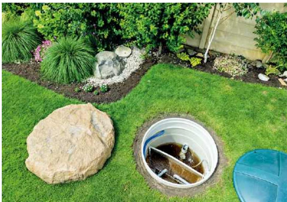
❶ Właściwie dobrana, wykonana i eksploatowana oczyszczalnia nie wydziela przykrych zapachów i praktycznie nie wymaga obsługi. EKOHOUSE TECHNOLOGIE EKOLOGICZNE
