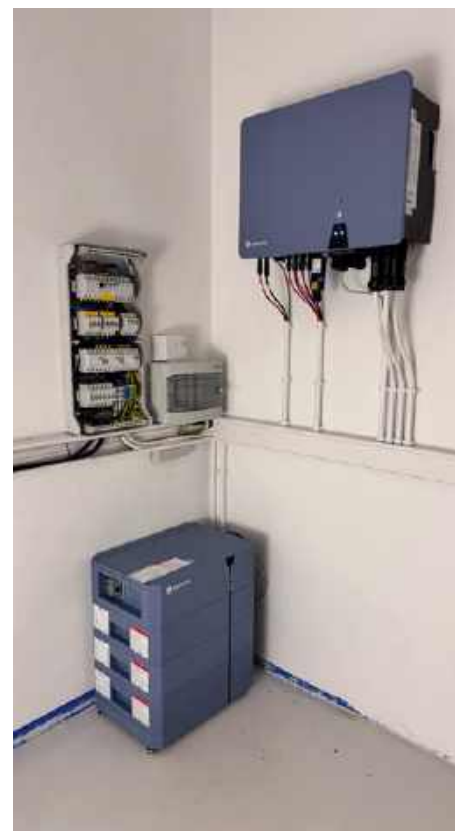
Instalacja hybrydowa Solplanet wykonana przez firmę LemonEnergy.pl. SOLPLANET/LEMONENERGY.PL
