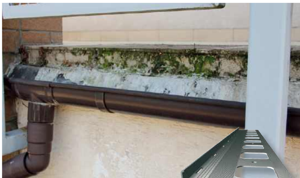
☹️ Szczególnie zły stan krawędzi tarasu to po części skutek braku okapnika umieszczonego pod płytkami. J. WERNER, RENOPLAST
