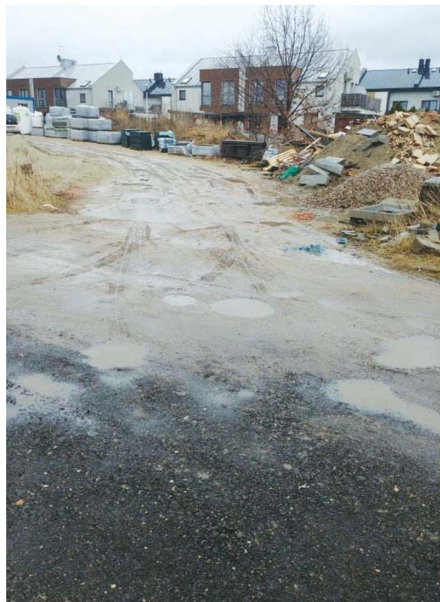
Błoto z budowy trafia na drogi publiczne
