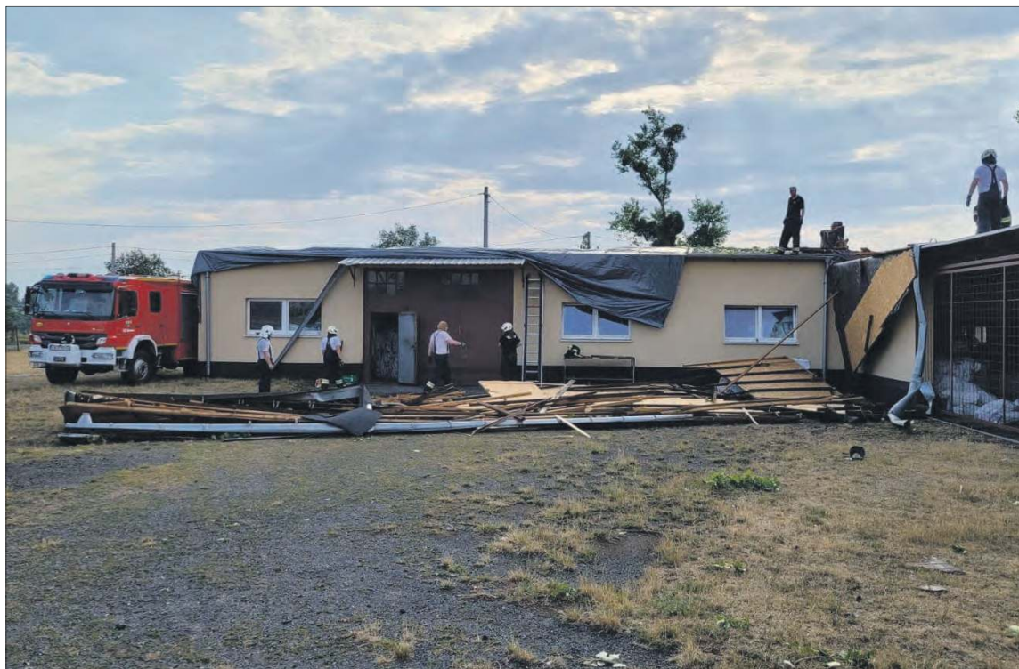
Jeden z uszkodzonych budynków
