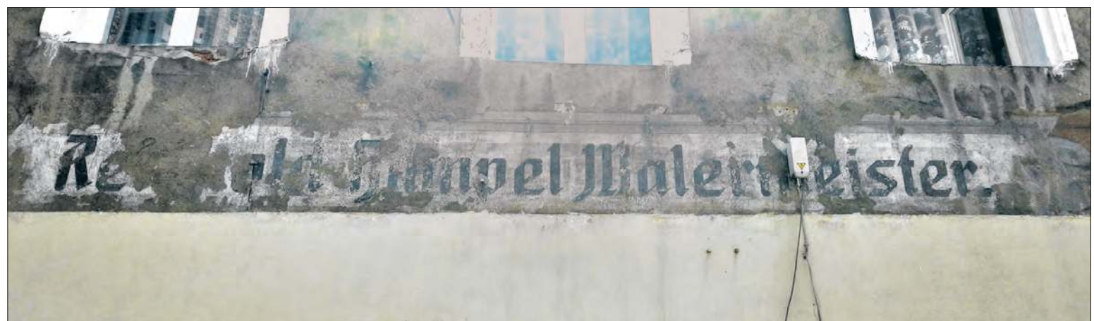
Jeden z licznych, niemieckich napisów firmowych w Prudniku. Ten znajduje się na ul. Górnej. Czy podczas remontu elewacji zostanie uratowany?
