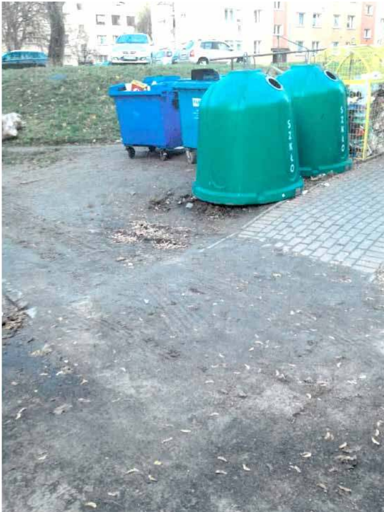
Naprawy i utwardzenia wymaga nawierzchnia pod śmietnikami
