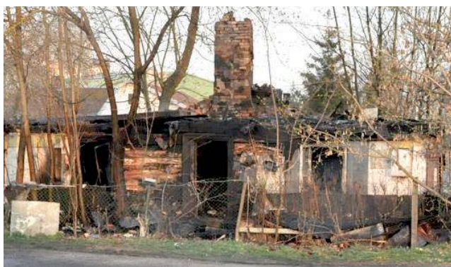
Spalony budynek przy ul. Nowej
