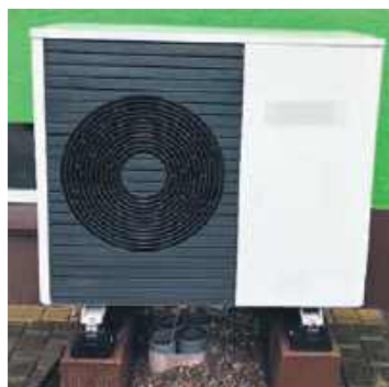
Przykład pompy ciepła o mocy 7 kW, która ogrzewa budynek z lat 80. o powierzchni 160 metrów kwadratowych. Fot. nadesłane
