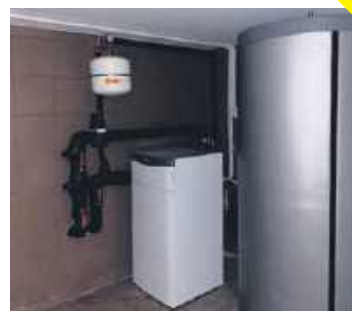
Gruntowa pompa ciepła o mocy 19 kW, ogrzewająca budynek o powierzchni 450 m². Fot. nadesłane z montażem wkładu kominowego lub budową nowego komina. Kotła na pellet nie powinno się podłączać do starych, murowanych kominów z cegły, ponieważ niska temperatura spalin sprzyja kondensacji, co prowadzi do powstania ciemnych plam i zacieków.
