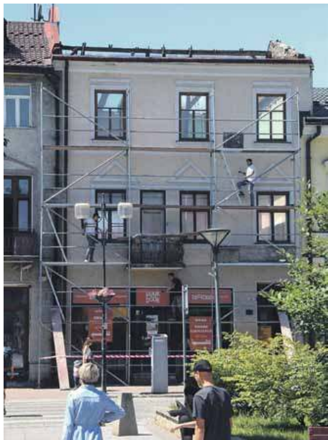
Z kamienicy przy Rynku została jedynie frontowa ściana.
