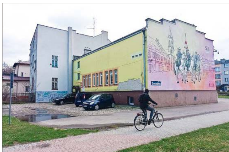
Stan elewacji siedziby DD Senior+ pozostawia wiele do życzenia.
