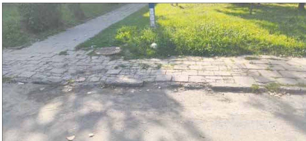
Zniszczony chodnik przy ul. Powstańców Śląskich
