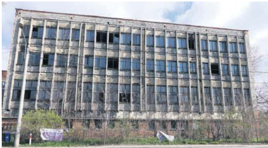
Przy ulicy Pocztowej w Wiązowie od lat stoi zrujnowany budynek po byłych zakładach obuwniczych
