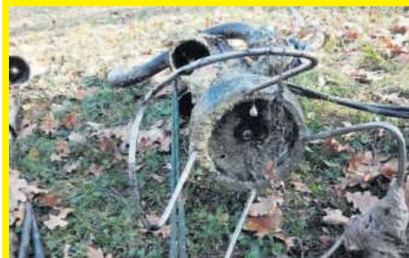
Tak wygląda jedna z pomp po awarii. Już niedługo na terenie gminy zostanie zamontowanych 30 nowych urządzeń
