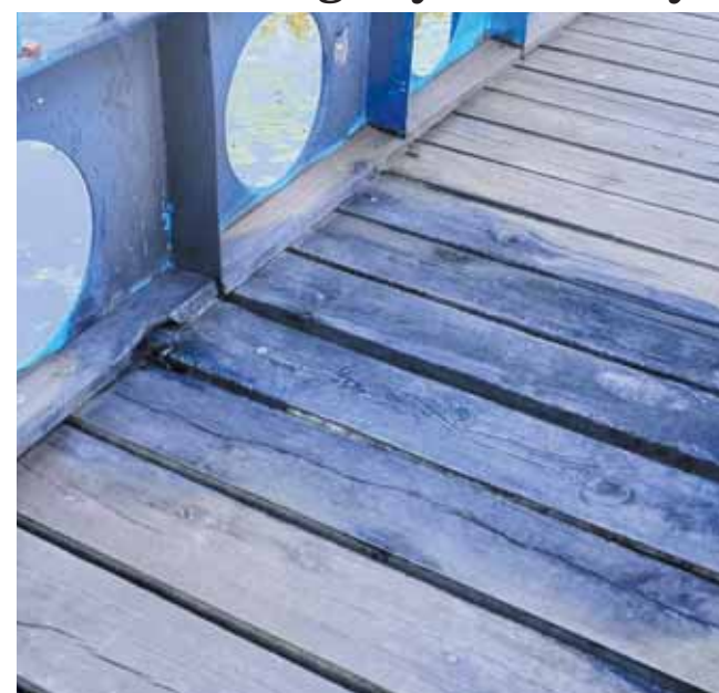
Ktoś podpalił mostek w Pniowcu
