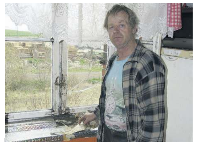
Zdaniem służb PKP, spróchniała stolarka okienna nie stanowi zagrożenia
