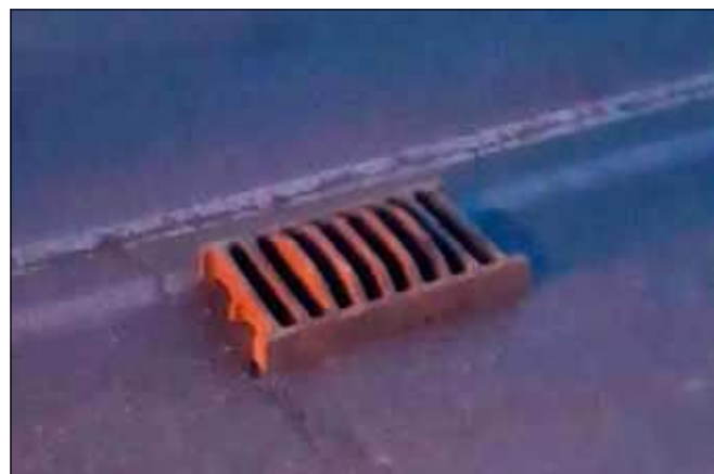
Ktoś powyciągał kratki i pokrywy studzienek i pokładał na drodze.
