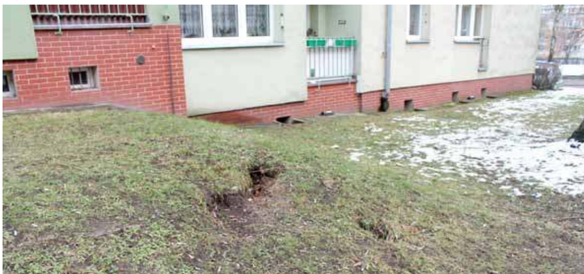
Widoczne na zdjęciu dziury w skarpie pod blokiem, mają być według jednego z mieszkańców, "dziełem" szczurów
