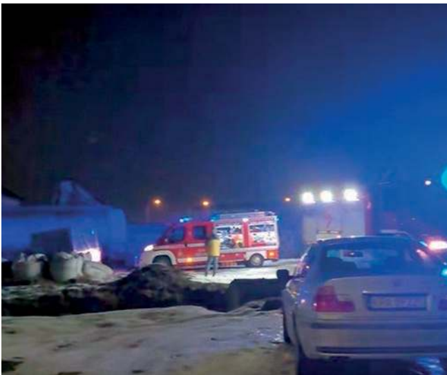
Pod halę magazynową w Trzebini przyjechało 20 zastępów straży
