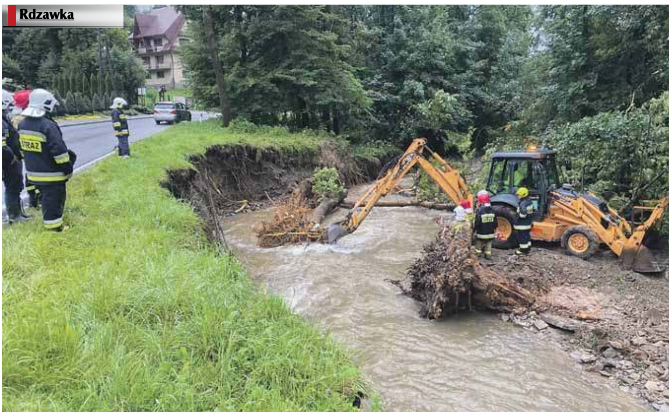
Sierpniowa powódź poważnie uszkodziła drogę w Rdzawce.
