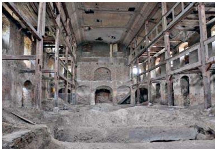
Tak ewangelik wyglądał przed rewitalizacją...
