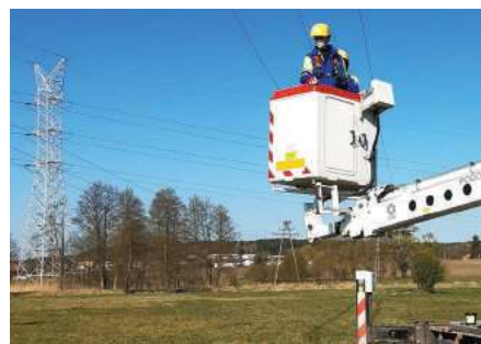
Od początku epidemii koronawirusa pracownicy Grupy Enea wykonują codziennie swoje zadania, dbając o nieprzerwane dostawy energii elektrycznej
