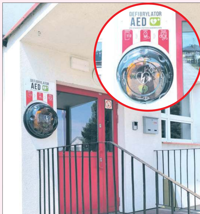
Defibrylator AED zamontowano przy wejściu głównym do Zespołu Szkolno-Przedszkolnego w Łaszczowie.
