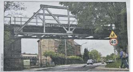
Zdaniem właściciela wiaduktu, jego stan techniczny jest zły
