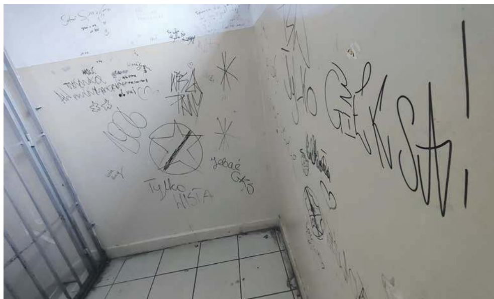
... pobazgrane ściany na klatce schodowej
