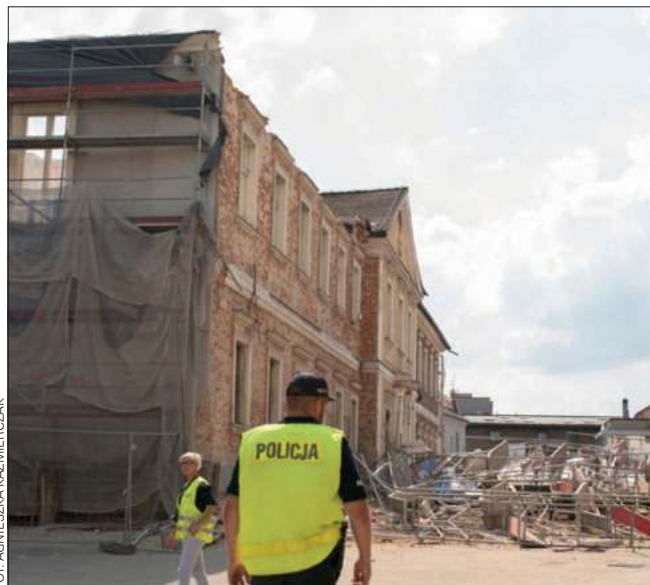
Jedną z dwóch katastrof budowlanych, do których doszło w zeszłym roku była ta w pałacu Dietrichsteinów w Wodzisławiu Śl.
