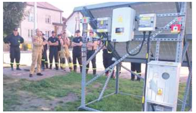
Do ćwiczeń wykorzystano specjalny trenera fotowoltaiki
