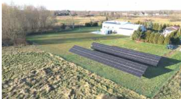
Instalacja fotowoltaiczna dla oczyszczalni ścieków we Frampolu jest już gotowa
