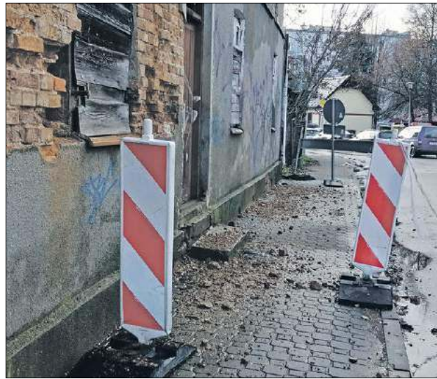
Kamienica przy ul. Budkiewicza ma być rozebrana. Na razie strach koło niej przechodzić
