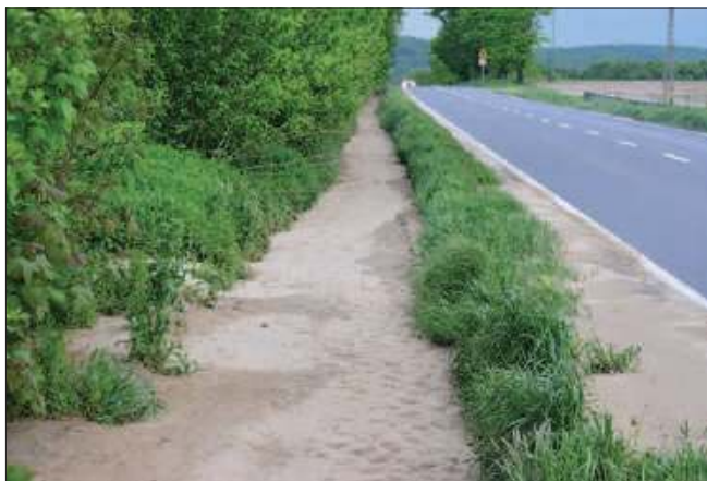
Rów odgradzający pola na Kopcu od drogi w czasie ulewy został całkowicie zamulony
