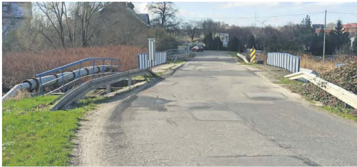
W czasie przeglądu stwierdzono zły stan mostu na ul. Brzegowej w Strzelinie
