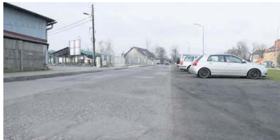
Ulica L. Okulickiego w Strzelinie, która jest w bardzo złym stanie technicznym, w tym roku zostanie odremontowana
