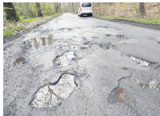
Droga z Gębiczyc do Romanowa na odcinku leśnym jest w katastrofalnym stanie
