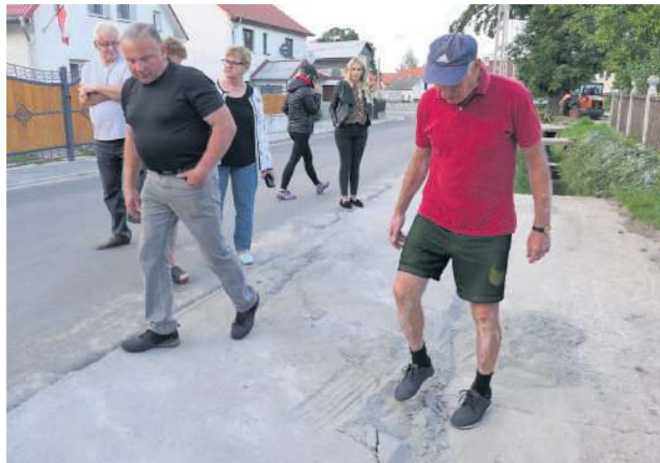
Mieszkańcy uważają, że remont to w wielu miejscach zwykła fuszerka. Na dowód pokazują utwardzenie pobocza, które... rozchodzi się pod nogami
