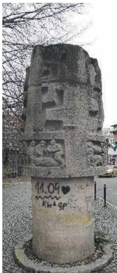
Tak było przed renowacją...
