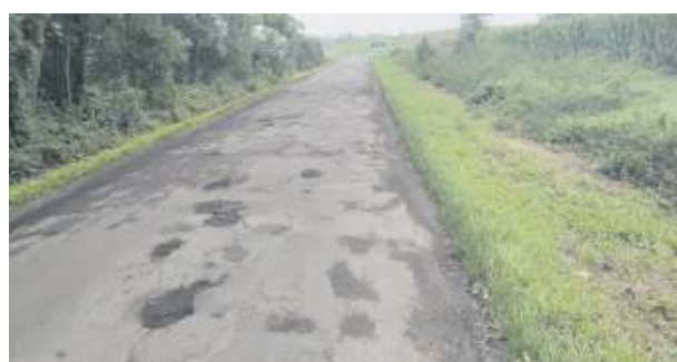
Stan drogi Kondratowice - Białobrzezie wymagał natychmiastowej interwencji
