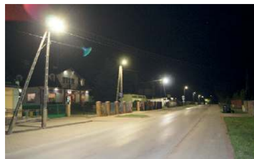
Zmodernizowane oświetlenie uliczne
