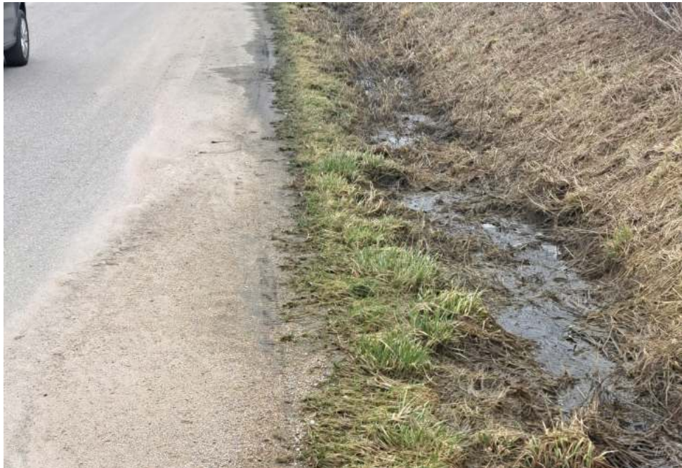
Tak wygląda ODWODNIENIE drogi
