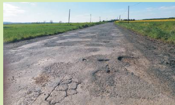
Droga z Rożnowa do Królewca jest w fatalnym stanie i od dawna wymaga gruntownego remontu
