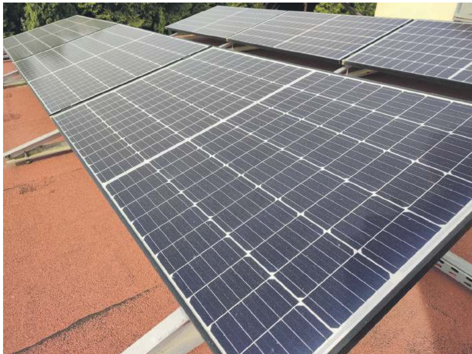
Fotowoltaika na budynkach użyteczności publicznej i na obiektach prywatnych stała się popularnym źródłem pozyskania darmowej energii
