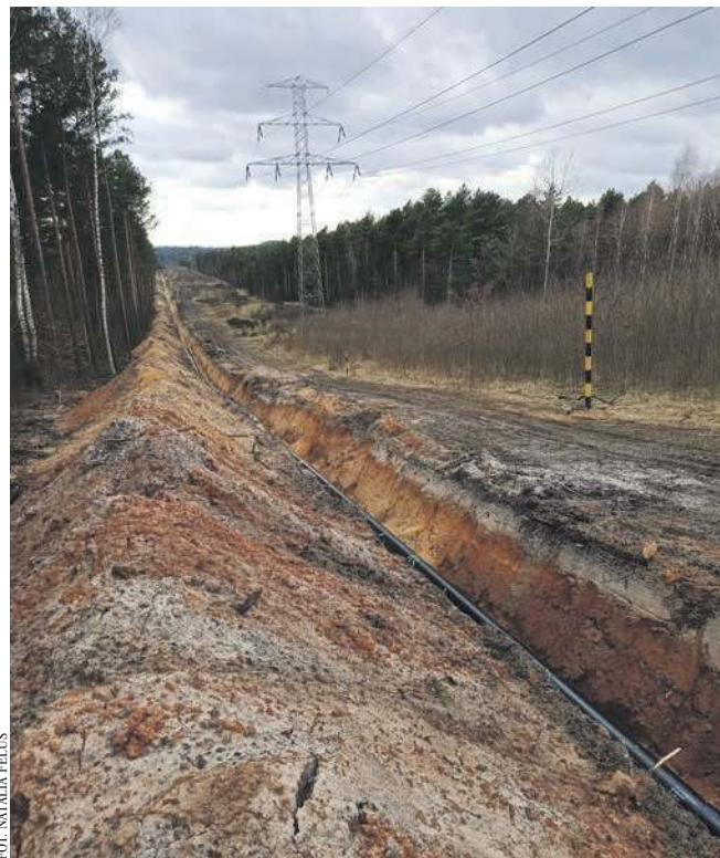
Rurociąg z Boronowa do Trzebini na wysokości os. Gaj
