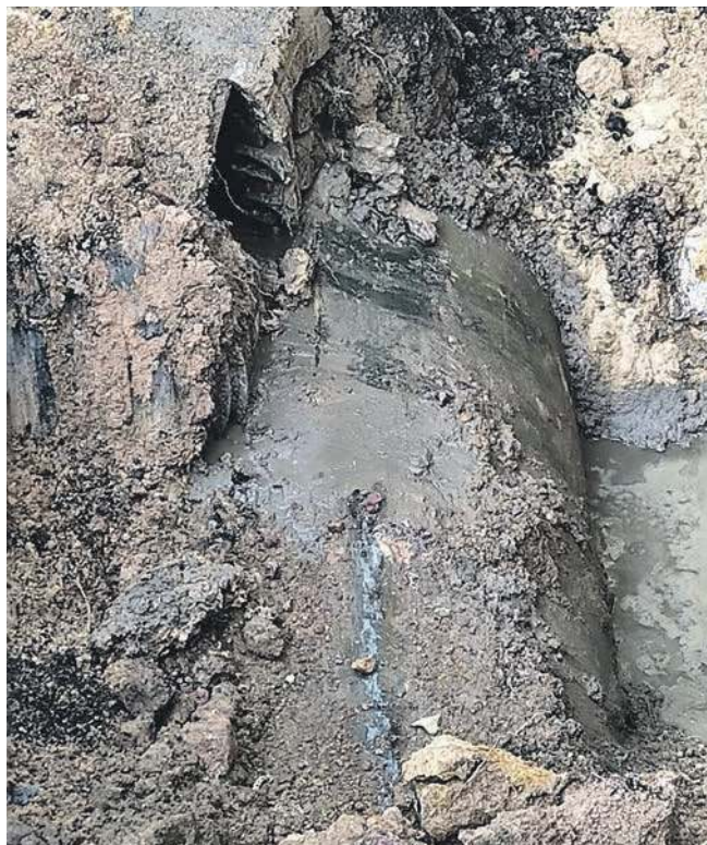
Awaria wodociągu w Sierszy
