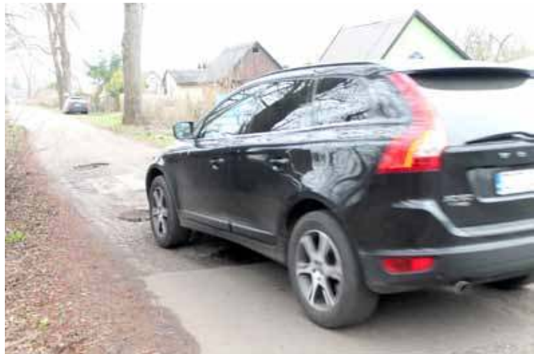
Kierowcy tutaj za szybko nie pojadą, bo grozi to uszkodzeniem samochodu
