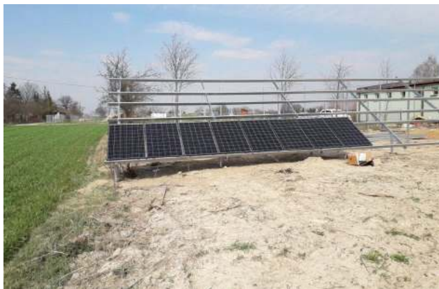
Panele fotowoltaiczne na obiekcie hydroforni gminnej w Zbroszkach
