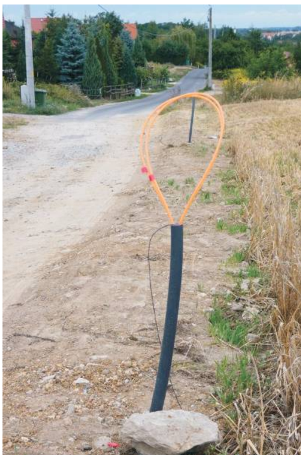
Tak wyglądały rurki światłowodowe w 2019 roku. Dziś są zarośnięte trawą, a w niektórych miejscach trudno je odnaleźć. Foto: archiwum Słowa
