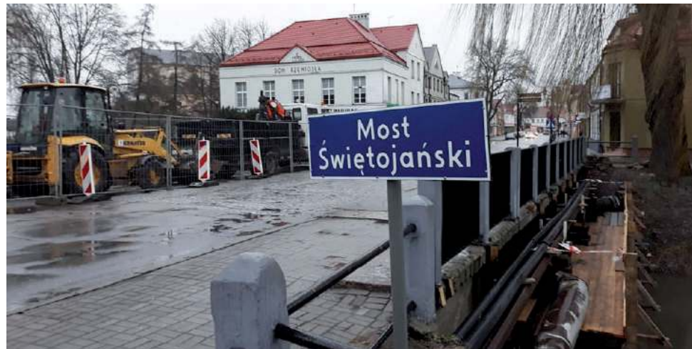
Część mostu wyłączona z ruchu
