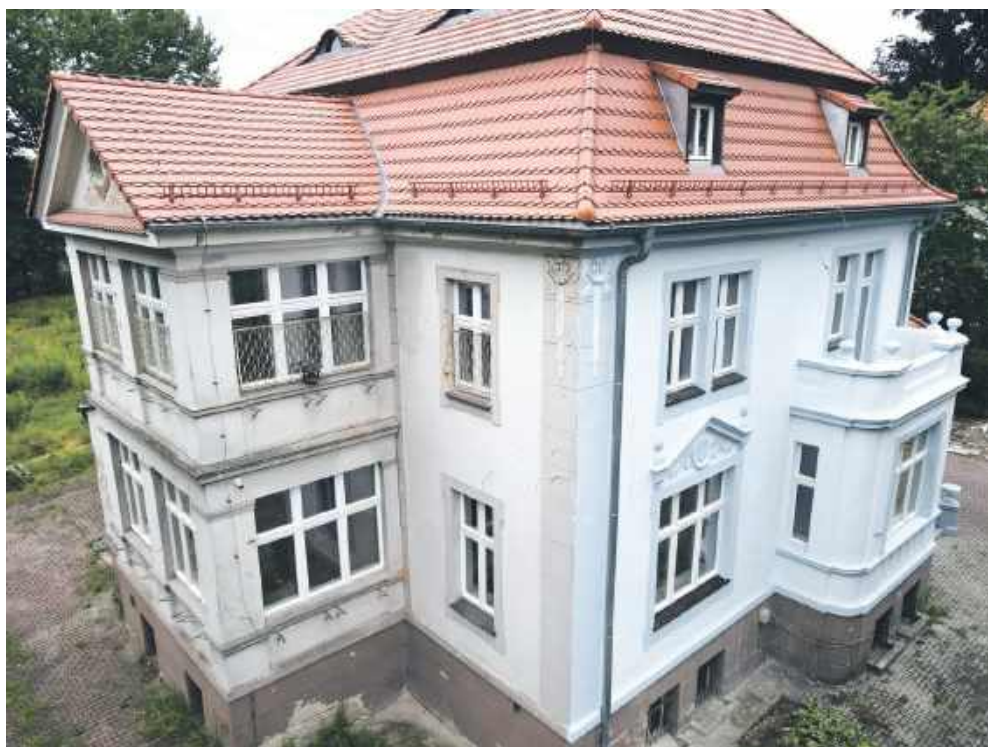
To widzimy, że jedna ze ścian nie została wyremontowana
