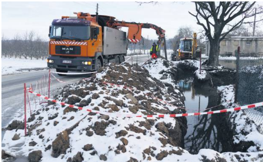
Z powodu mrozów pękła 150 mm rura. Awarię usunięto 1 grudnia
