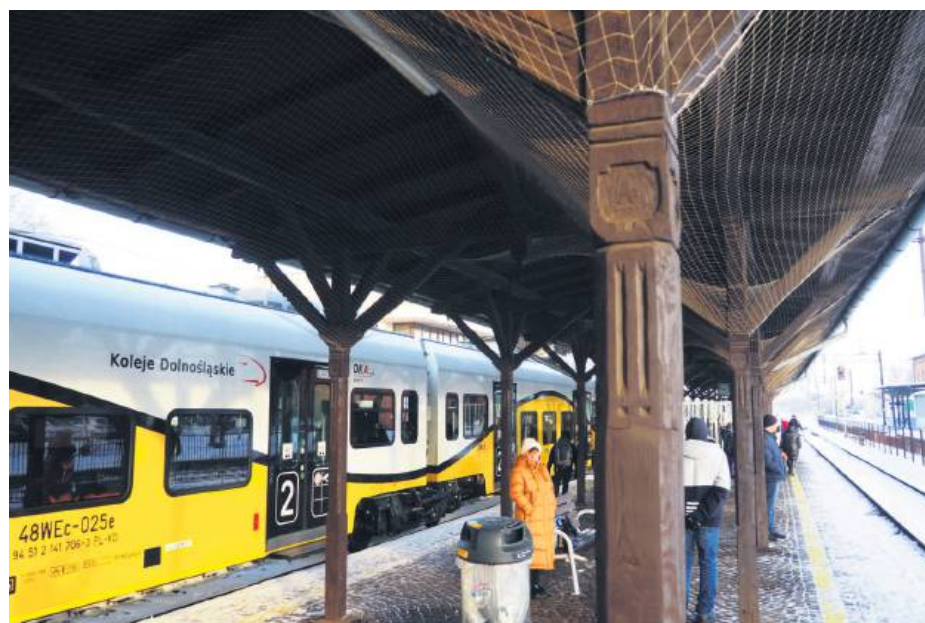
Problem z odchodami na dworcu istniał od zawsze. Doszło do tego, że podróżni omijali ławki. Na zdjęciu widać podwieszone siatki
