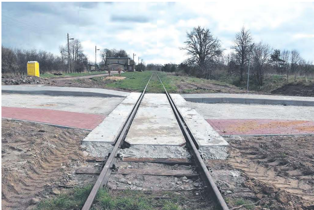
Przejazd przez tory. Z tym elementem było najwięcej problemów.
