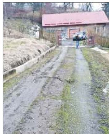
Piotr Matłok jest przekonany, że zniszczenia spowodowała osuwająca się ziemia.
