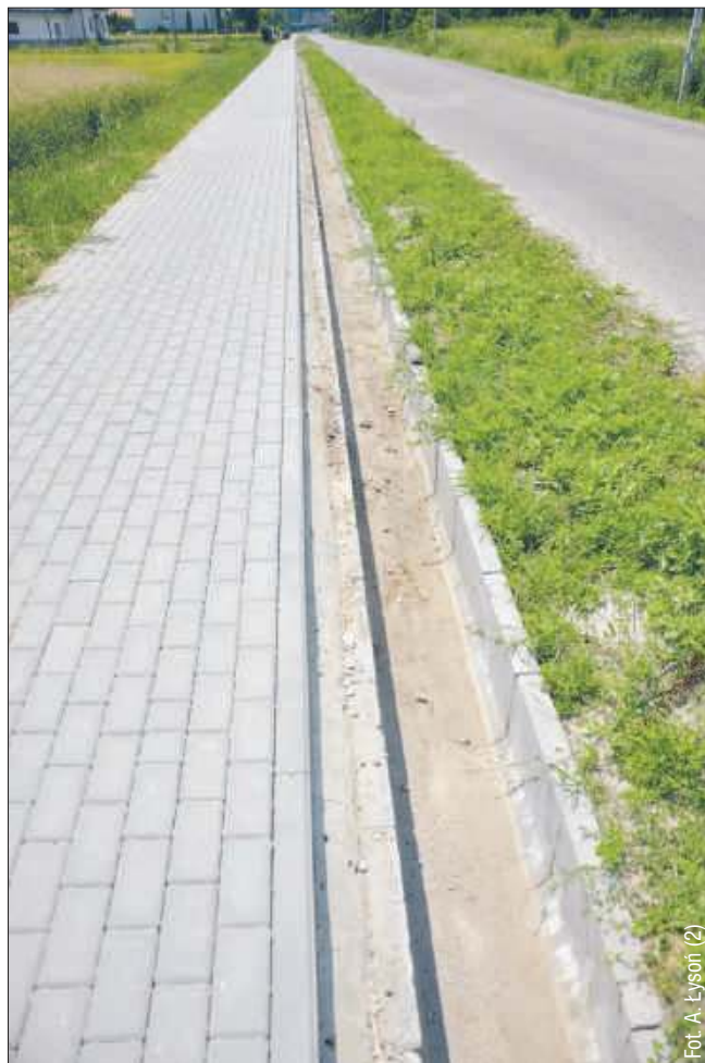
Głęboki na pół metra betonowy rów zdaniem mieszkańców jest zagrożeniem dla pieszych i rowerzystów.
