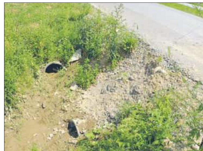
Po deszczu kamień spłynął do rowu.
