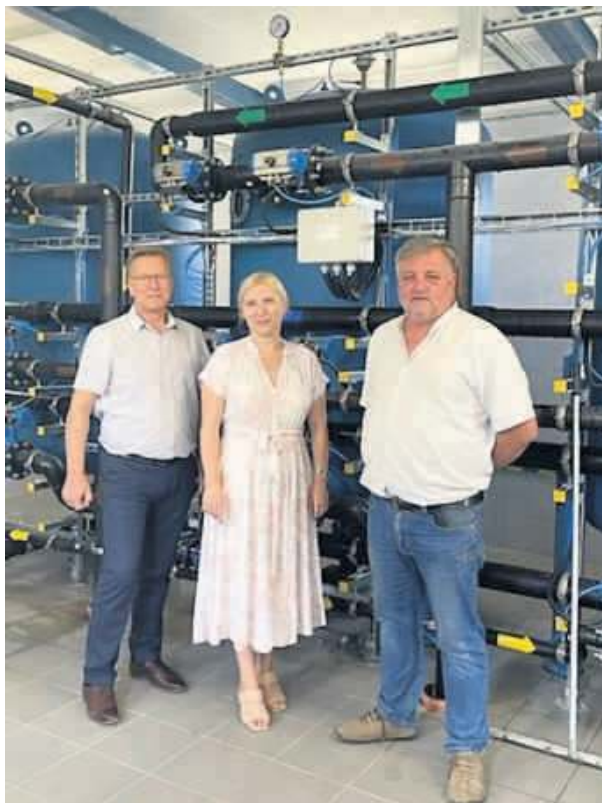
Od lewej: wójt Andrzej Łuczak, kierownik Zakładu Usług Komunalnych w Przewornie Justyna Białecka oraz właściciel firmy Ciepły Dom Dariusz Pożuczek w zmodernizowanej Stacji Uzdatniania Wody w Karnkowie
