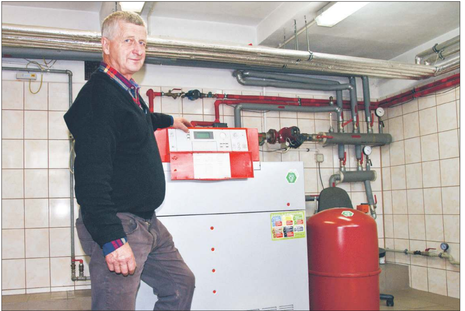
Konserwatorem instalacji centralnego ogrzewania w Urzędzie Gminy w Jodłowej jest Stanisław Zawisłak.
