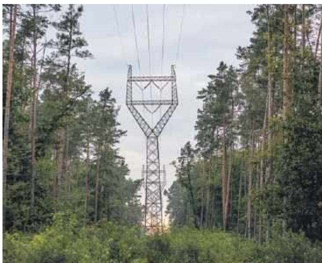
Linia 220 kV Glinki - Reclaw. Zastosowano innowacyjne słupy śródełne, pozwalające ograniczyć do niezbędnego minimum wycinkę drzew.
